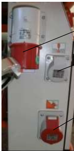
Рис. 6: Описание распределительного шкафа и разъемов
